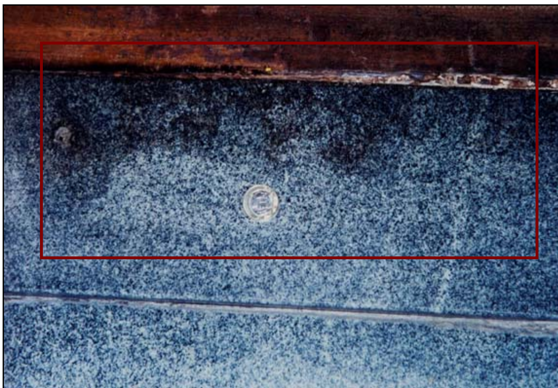
FOTO 124 - INFILTRAÇÃO DE ÁGUA PELAS JUNTAS EM SOLERIA DE GRANITO - BOTUCATU, SP
