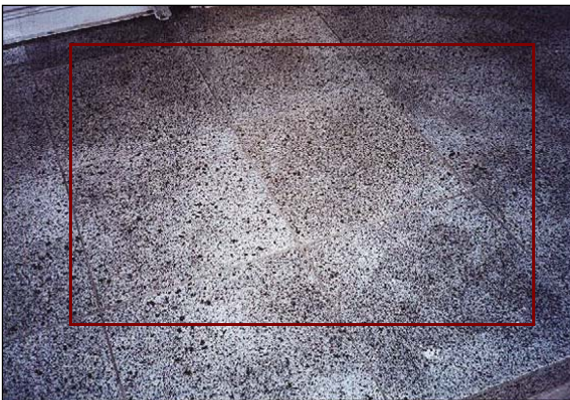
FOTO 119 - MANCHAS DE UMIDADE NA SUPERFÍCIE DAS PLACAS (30x30 cm) NO PISO, PROVOCADAS POR EXCESSO DE ÁGUA NA ARGAMASSA - BAURU, SP
