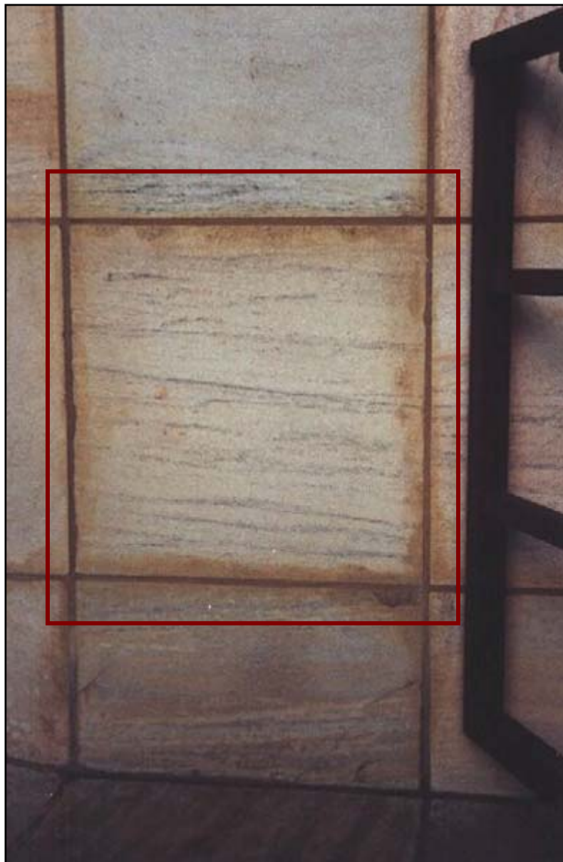
FOTO 122 - FACHADA DE LABORATÓRIO APRESENTANDO AS BORDAS DAS PLACAS DE QUARTZITO MANCHADAS DEVIDO À FALTA DE LIMPEZA DA MASSA DO REJUNTAMENTO - BOTUCATU, SP
