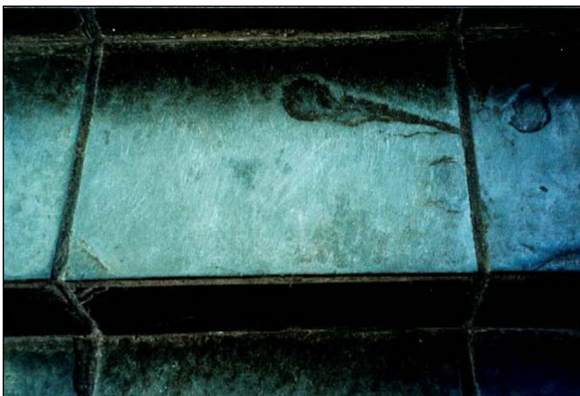
FOTO 3- DETALHE DA PATOLOGIA OBSERVADA NA FOTO ANTERIOR, O DESGASTE DA PELÍCULA DE SINTECO MANCHOU O MATERIAL DE REVESTIMENTO, ALÉM DE DESPROTEGER AS PLACAS DO DESGASTE ABRASIVO
