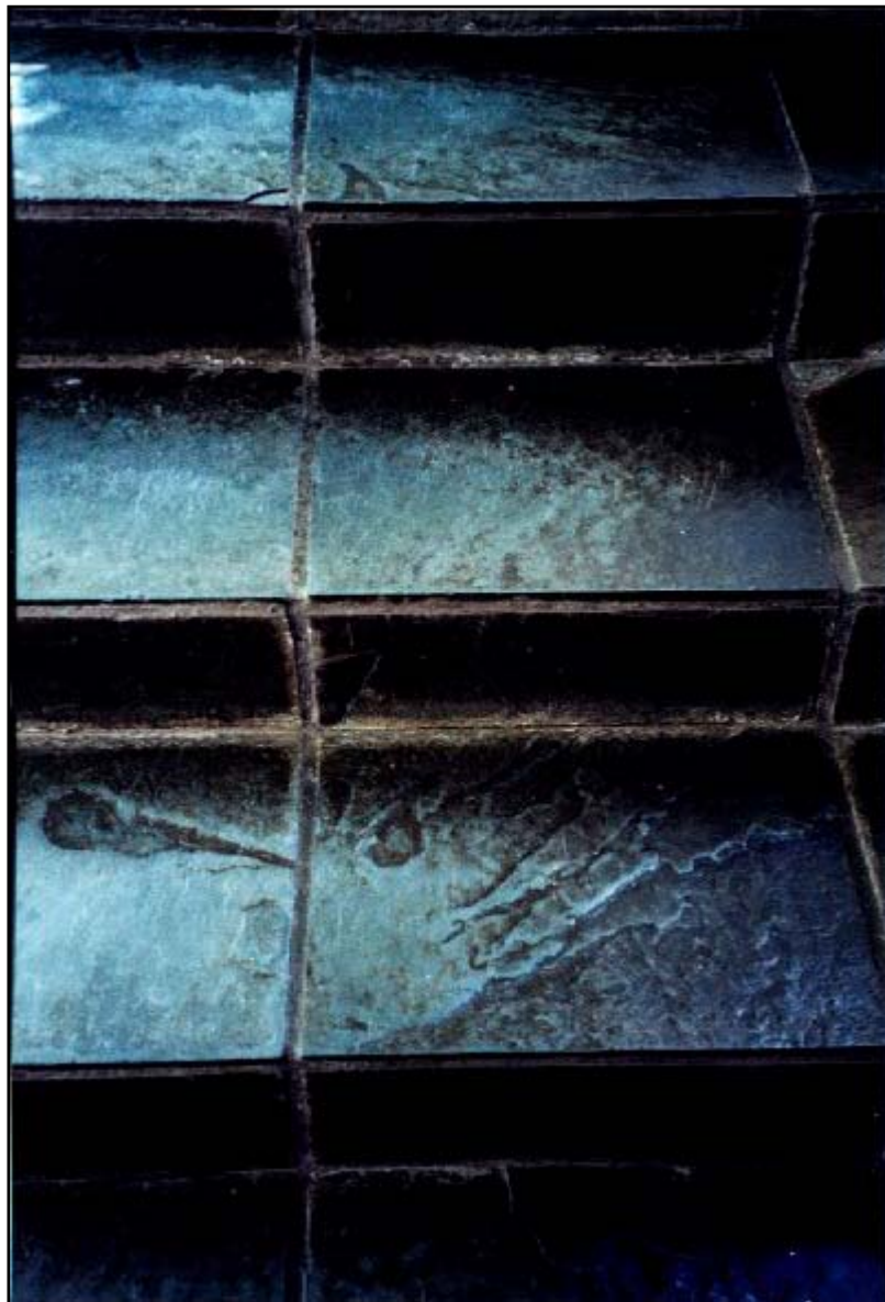
FOTO 2 - FOTO ILUSTRANDO MANCHAMENTO PROVOCADO PELA UTILIZAÇÃO DE PELÍCULA PROTETORA DE SINTECO SOBRE PLACAS DE ARDÓSIA VERDE (20X30 cm) REVESTINDO ESCADARIA EM ENTRADA DE PRÉDIO DE APARTAMENTOS
