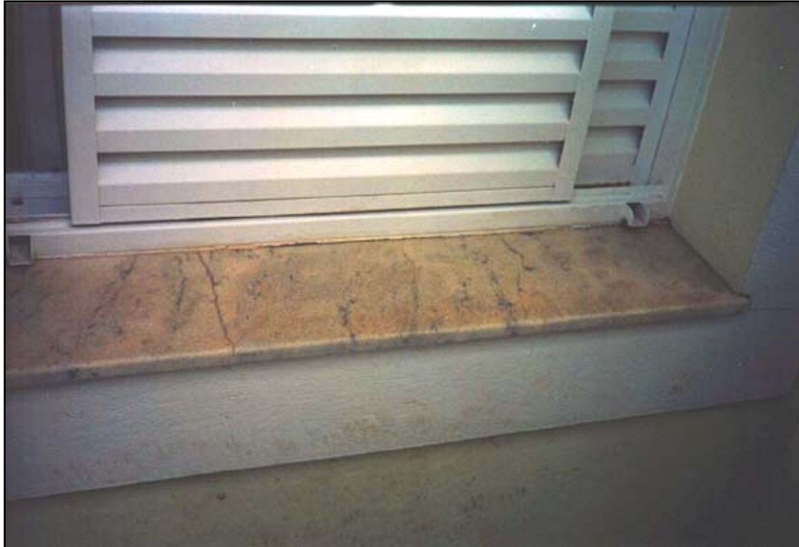
FOTO 4 - MANCHAS AMARELADAS EM MÁRMORE BRANCO (PEITORIL DE JANELA) CAUSADAS PELA DEPOSIÇÃO DE SUJEIRAS, NA SUPERFÍCIE DA PEÇA, QUE SÃO CARREGADAS, POR INFILTRAÇÃO, ATRAVÉS DOS PLANOS DE CLIVAGEM - BOTUCATU, SP
